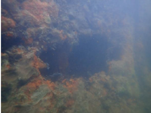
Figur 33 Hål genom sport och skyddsplåt i skvalpzon längs östra halvan av KP 106
